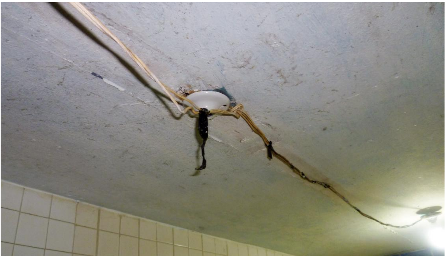
(15.2.) El área denominada Unidad de Reflexión no cuenta con luz ni ventilación natural, adicionalmente se observa que el funcionamiento del sistema de ductos de ventilación no es permanente.
